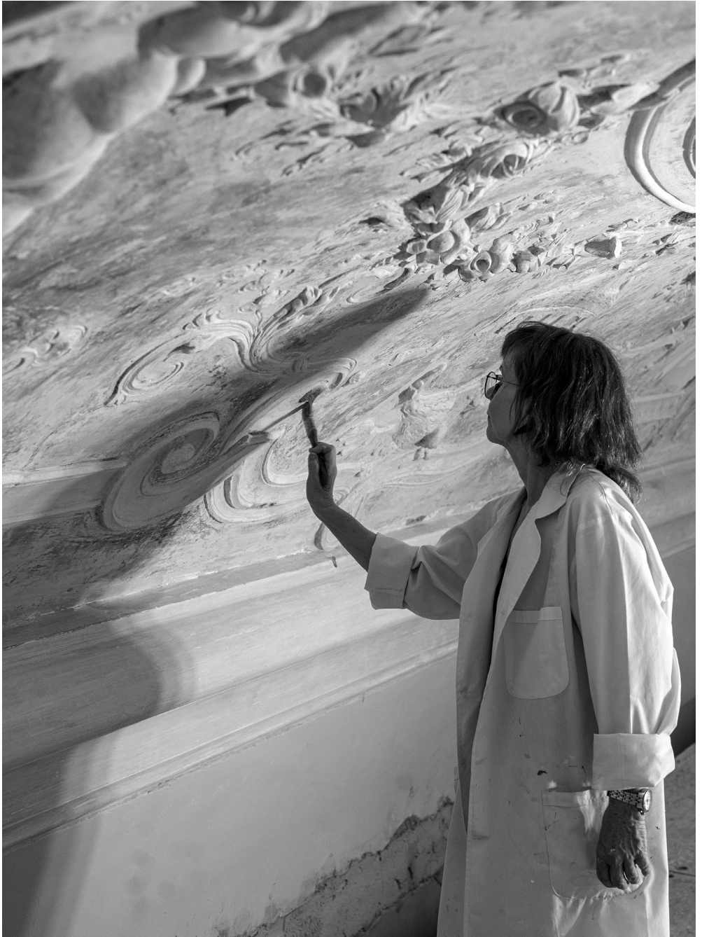
Hier wird eine der Stuckdecken im Gartenpalais restauriert. Foto: Kollektiv Fischka / Kramar
